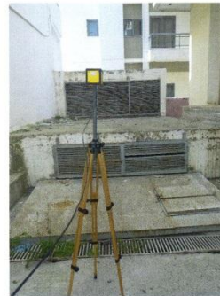
Φωτογραφία 3: Άποψη του χώρου ακριβώς πάνω από τον υπόγειο υποσταθμό διανομής ηλεκτρικής ενέργειας Νο75,
