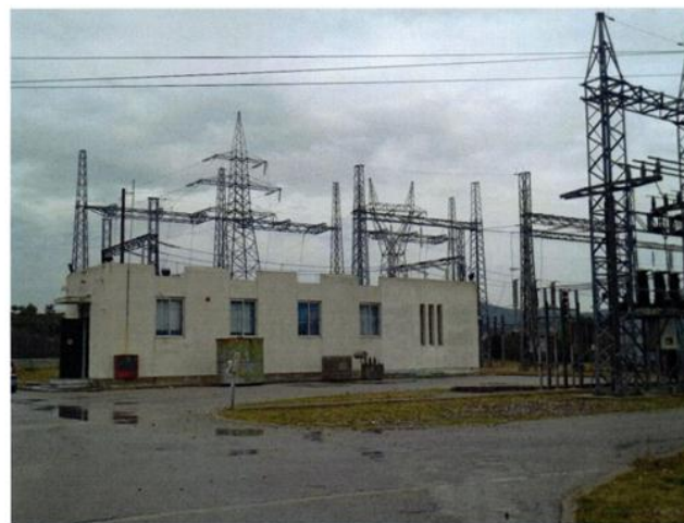
Φωτογραφία 2: Άποψη του Υ/Σ 150kV
