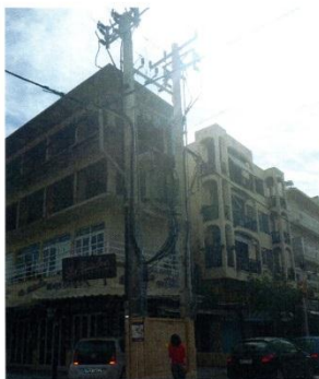
Φωτογραφία 2: Άποψη του εναέριου υποσταθμού διανομής ηλεκτρικής ενέργειας Νο41,
