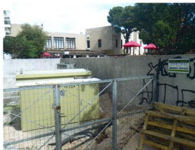
Φωτογραφία 1: Άποψη του υπέργειου υποσταθμού διανομής ηλεκτρικής ενέργειας Νο22Α
