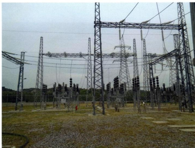
Φωτογραφία 1: Άποψη του Υ/Σ 150kV.
